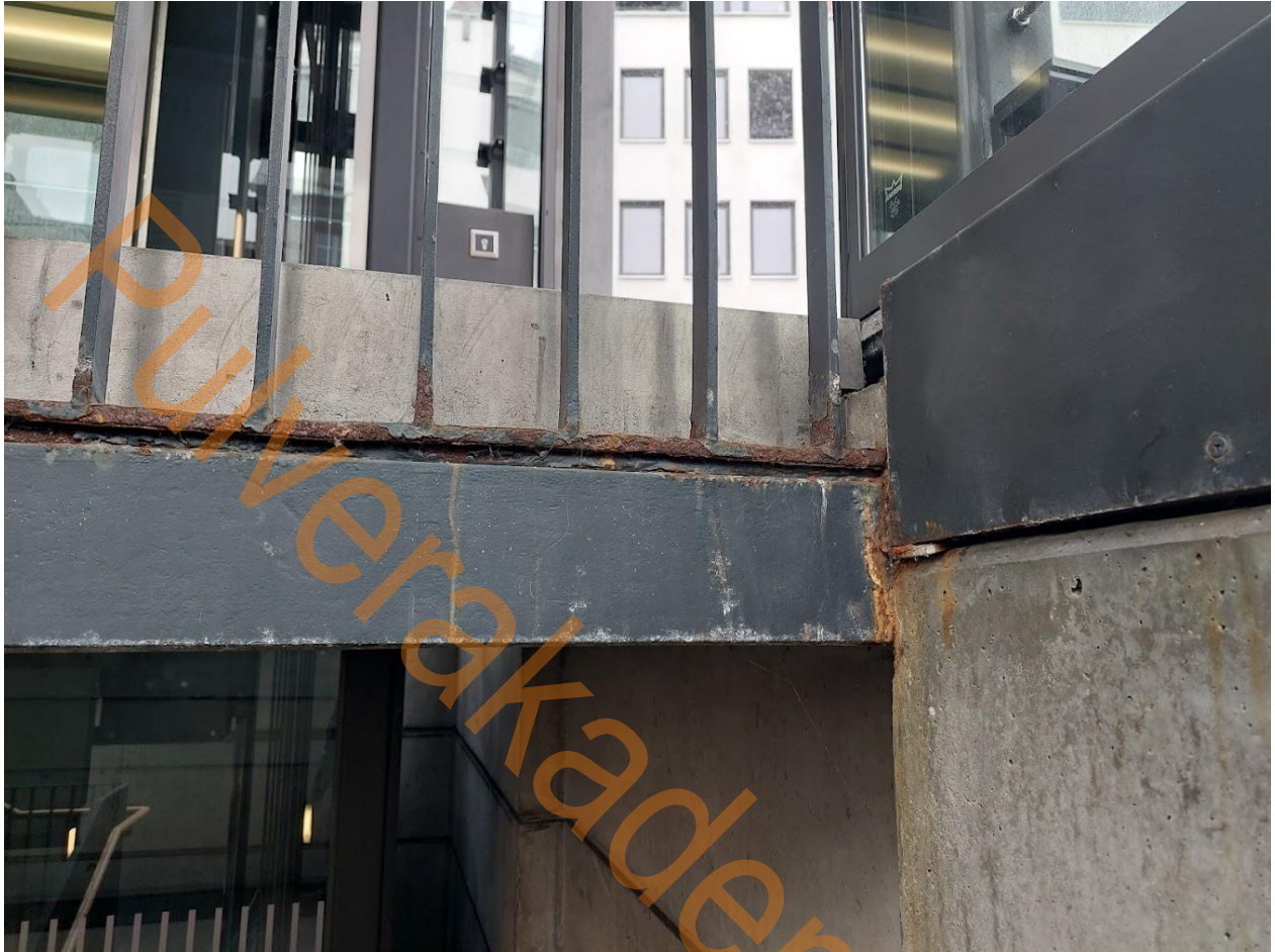
Bild 2 Stahlgeländer mit unzureichendem Rostschutz Ulm Parkhaus Foto Matthias Bader Pulverakademie
